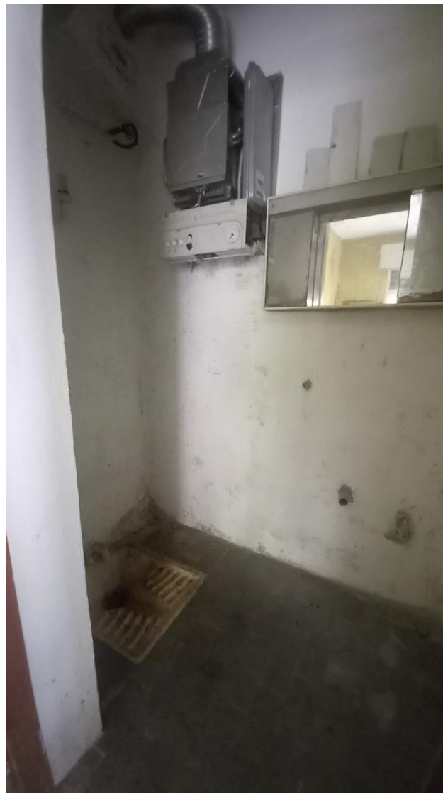
Foto 6: Servizio Igienico, con porzioni ammalorate e distacchi di intonaco e WC in pessimo stato ed impianti non in sicurezza
